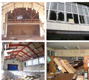
▲崩壊した天井等の非構造部材
